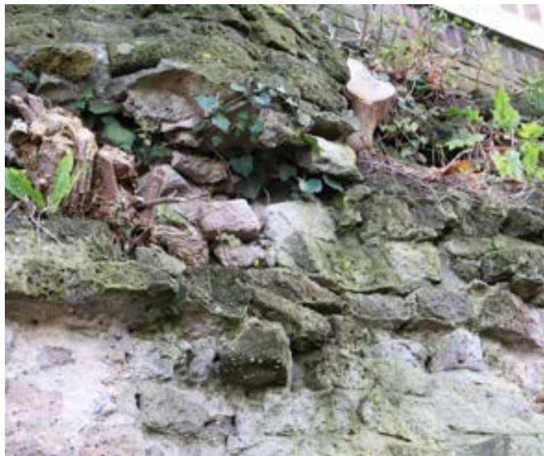
Schade aan de burchtmuur door beplanting
