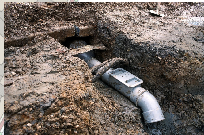
Foto van een controleput
